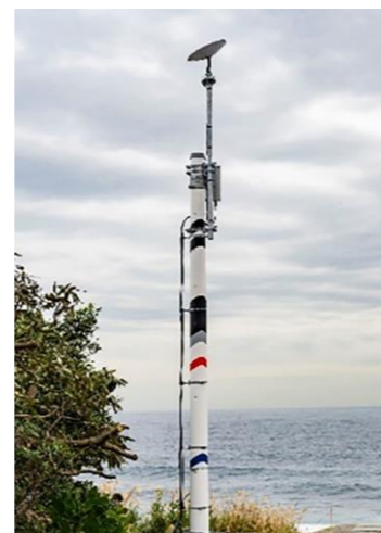
衛星回線を活用した基地局
